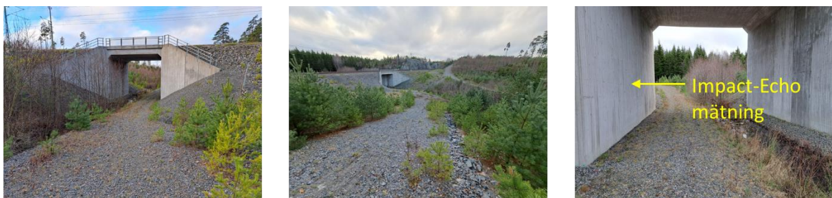
Figur 24. Plattrambro som utgör exempel för mätning med Impact-Echo tillsammans med systemet för datorseende.
